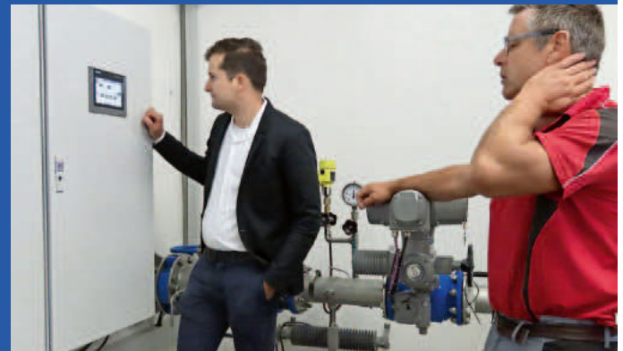
Die neue Steuereinheit liefert exakte Daten zur Einspeisung und zum Verbrauch
