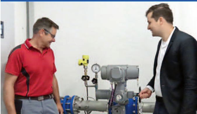
Bürgermeister Rupp und Wassermeister Schmidt öffnen die Schieber für Wasser aus Hausen
